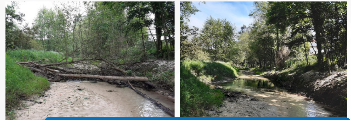
Foto 11. Trabajos de retirada de elementos que obstruyen los cauces dentro del Programa de mantenimiento y conservación de cauces
