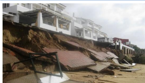
Destrozos temporal 2018. Fuente: MITECO
