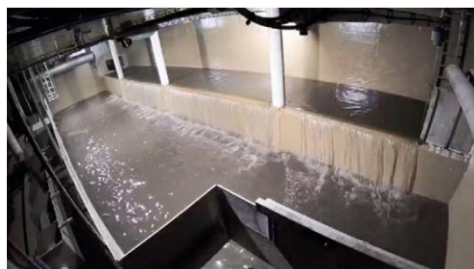
Tanque de Tormentas Plaza de Italia. El Sardinero (Santander - Cantabria). Fuente: HidroStank
