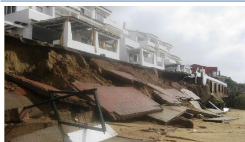
Destrozos temporal 2018. Fuente: MITECO
