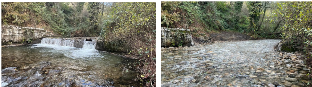
Demolición de azud en el río Ibias en Degaña (antes y después).
