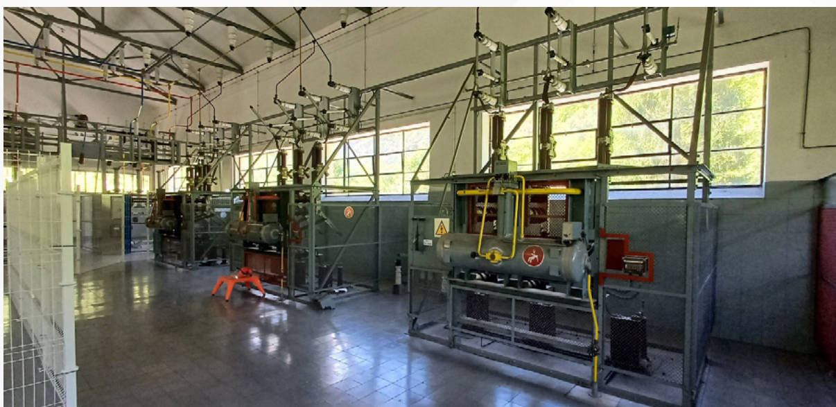
Instalaciones de la central de La Riera. Fuente: fondo documental del Organismo.
