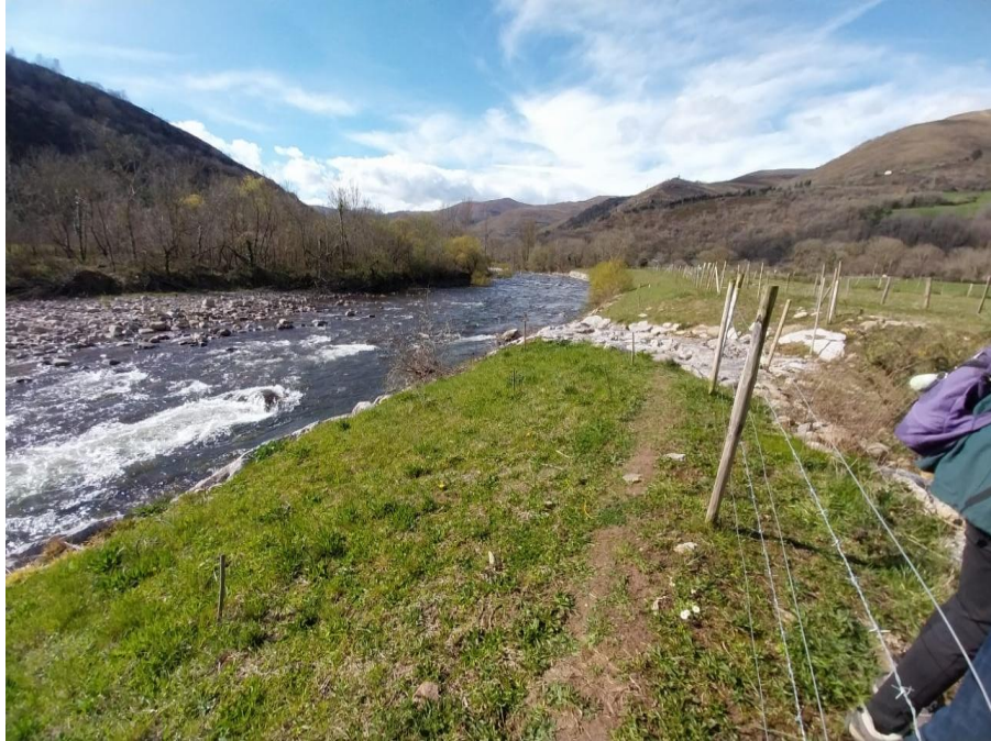
Foto 1. Estado inicial del canal secundario en zona de conexión con el cauce principal río Saja en su tramo inicial.
