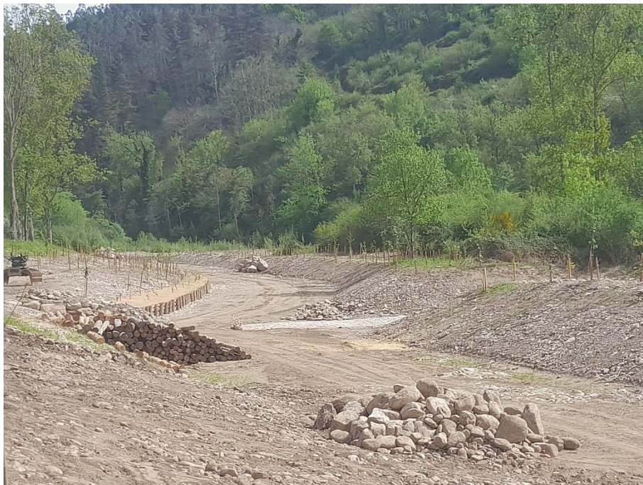
Foto 13. Estado del canal en su zona intermedia durante la ejecución del mismo.
