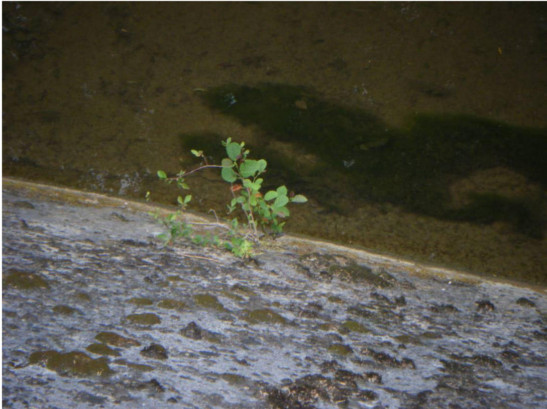
Fotografía nº 4.5. Tramo encajado en estructura de hormigón a la altura del polideportivo Gorostiza. Aliso ( Alnus glutinosa ) en el muro.
