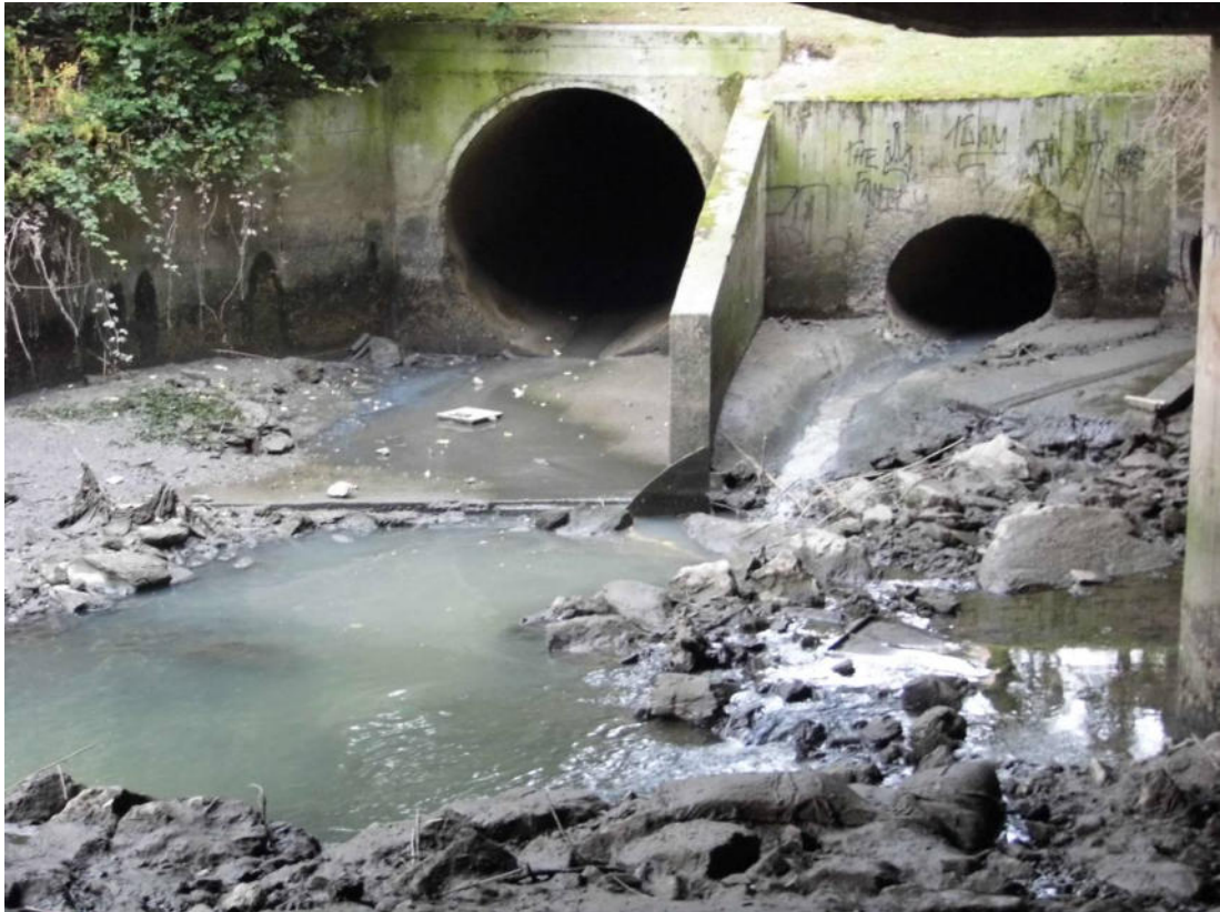
Fotografía nº 1.5. Punto de vertido a la altura del Centro Comercial Megapark.
