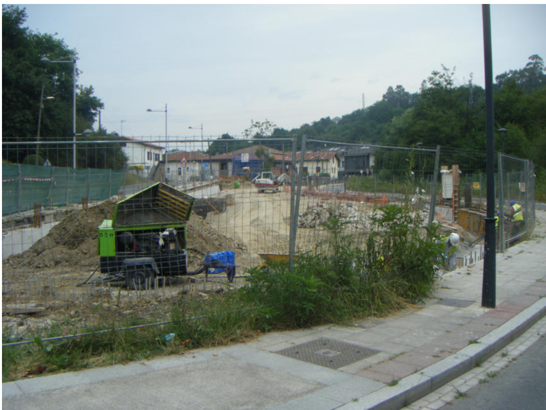
Fotografía nº 4.16. Obras en zona inundable del río Castaños en la Urbanización Iguliz-Gorostiza.
