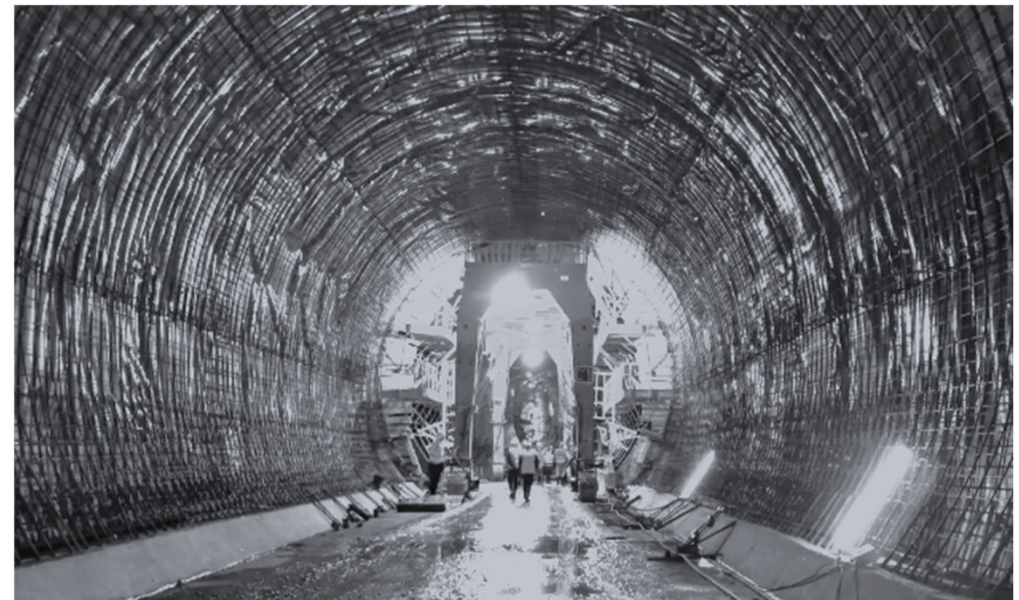
Tanque de tormentas de Lamiako
