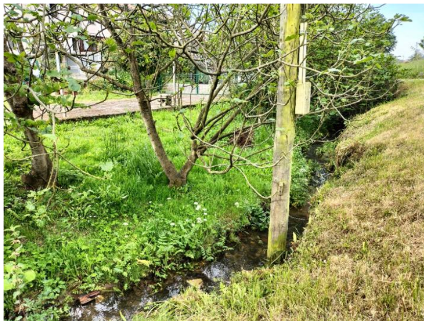
Foto 20. Ocupación de cauce por un poste eléctrico en el arroyo Reconco. Coordenadas ETRS 89, Huso 30T, X: 276036, Y: 4826040.
