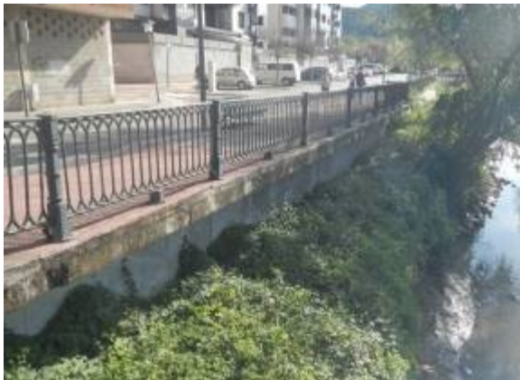
Foto 28 Zona a disponer muro en MD aguas arriba del puente de la c/Zubialde.
