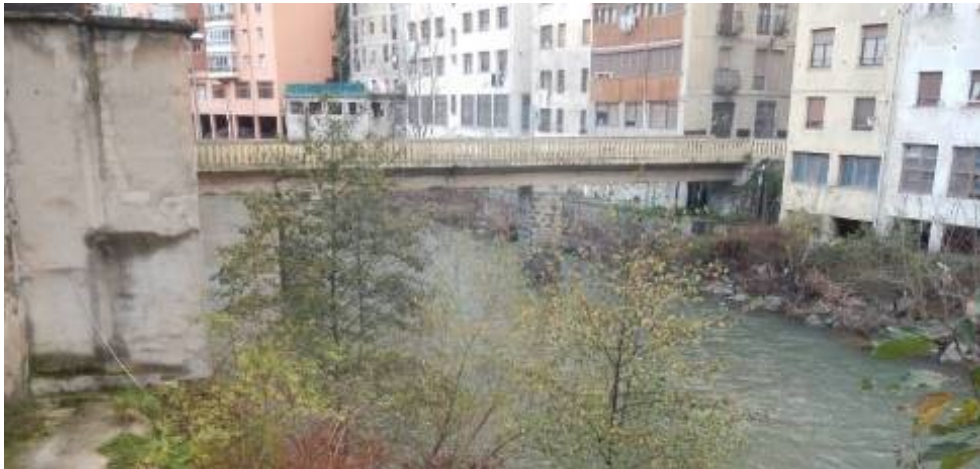
Foto 72 Pasarela a sustituir. PK 2+060.
