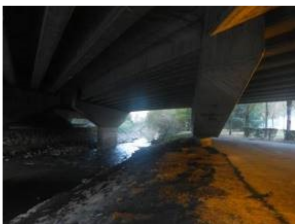
Foto 52 Punto de cierre de la mota con el estribo de la A-8 y zona para la disposición de muro. Se recomienda cerrar hasta tablero.
