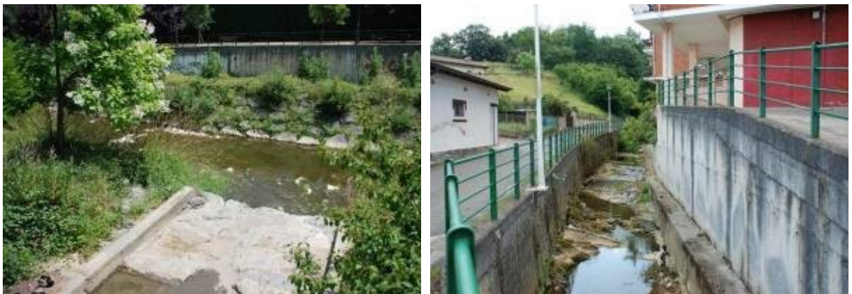
Foto 13 Arroyo Sapuela, en la desembocadura en el Nerbioi (en la imagen de la izquierda se observa la cobertura del cauce) y aguas arriba, encauzado.
