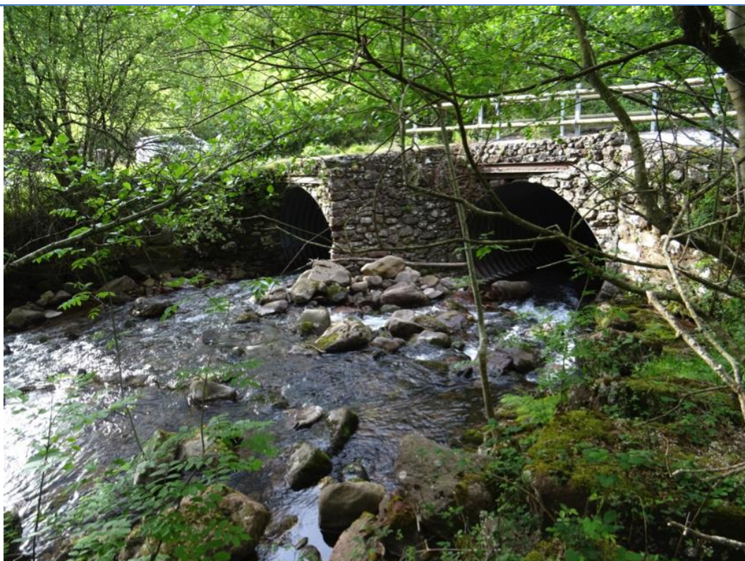
Doble paso entubado en el río Urrizate
