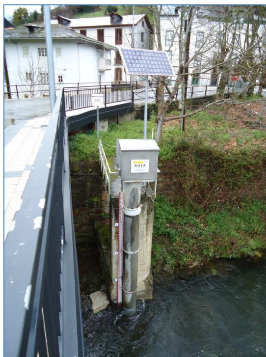
Figura 11.- Estación de aforo de la Red Oficial (ROEA) en el Río Esla en Treviás
