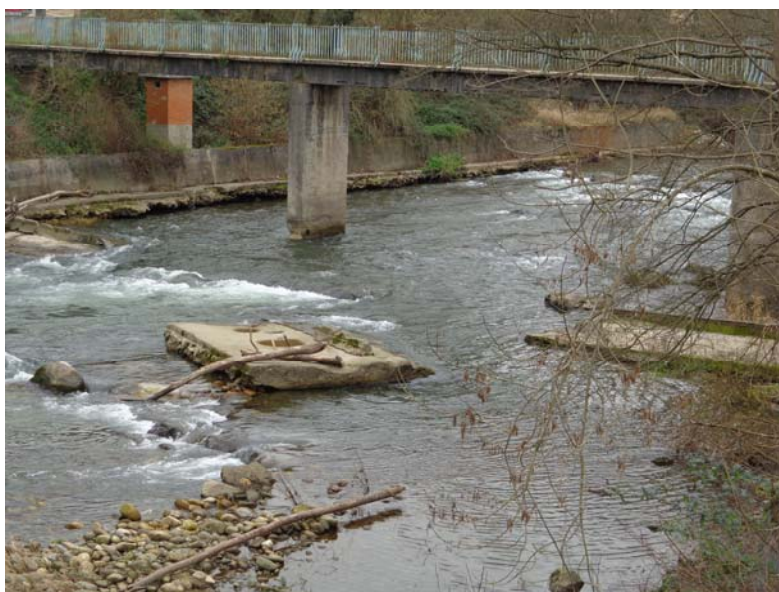
Zapata del muro lateral, bajo caseta de aforo totalmente descalzada y pila central.
