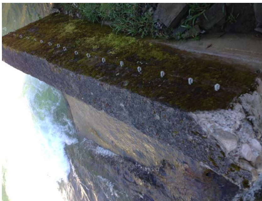
Muro volcado hacia en cauce.
