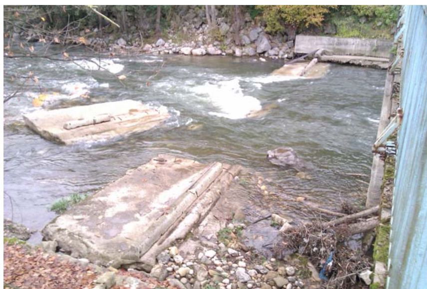
Parte de la losa desplazada aguas abajo junto a la desembocadura del río Morcín.
