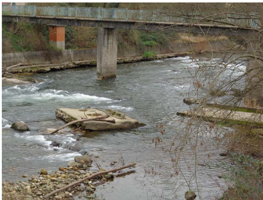
Zapara del muro lateral, bajo caseta de aforo totalmente descalzada y pila central.
