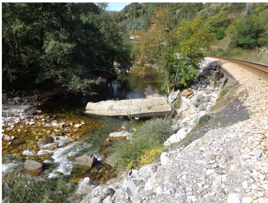
Bloque de hormigón aguas abajo del azud derruido.
