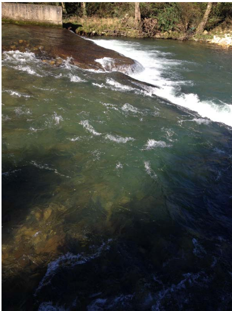
Lámina de control rota y cauce socavado tras el salto
