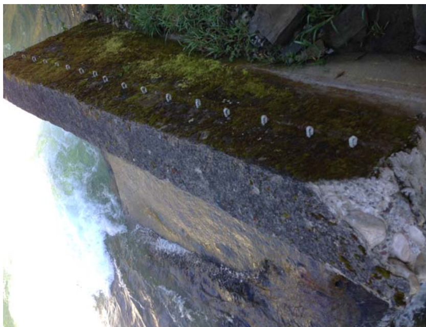
Muro volcado hacia en cauce.
