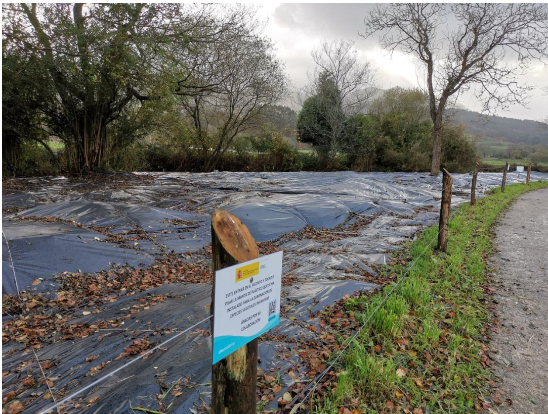
Estabilización y recuperación ambiental de la margen izquierda del río Esqueiro a su paso por Prámaro (Cudillero). Trabajos de eliminación de especies invasoras
