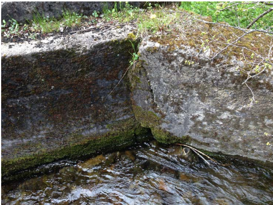
Cajeros erosionados en los cambios de dirección.
