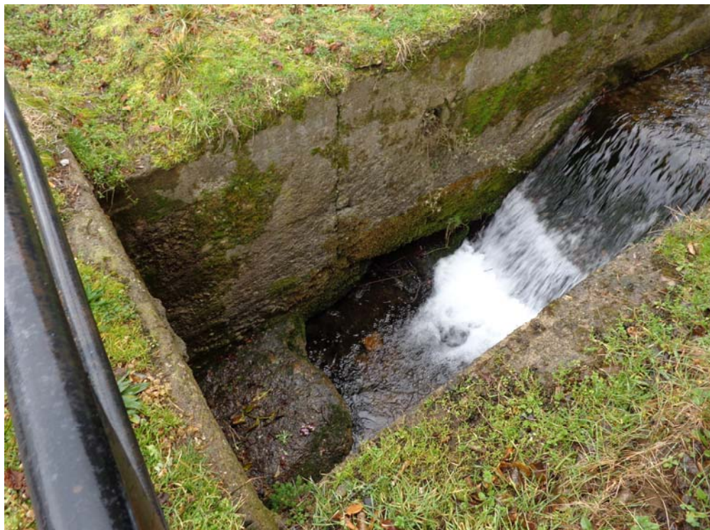
En este caso el agua penetra por debajo de la losa.
