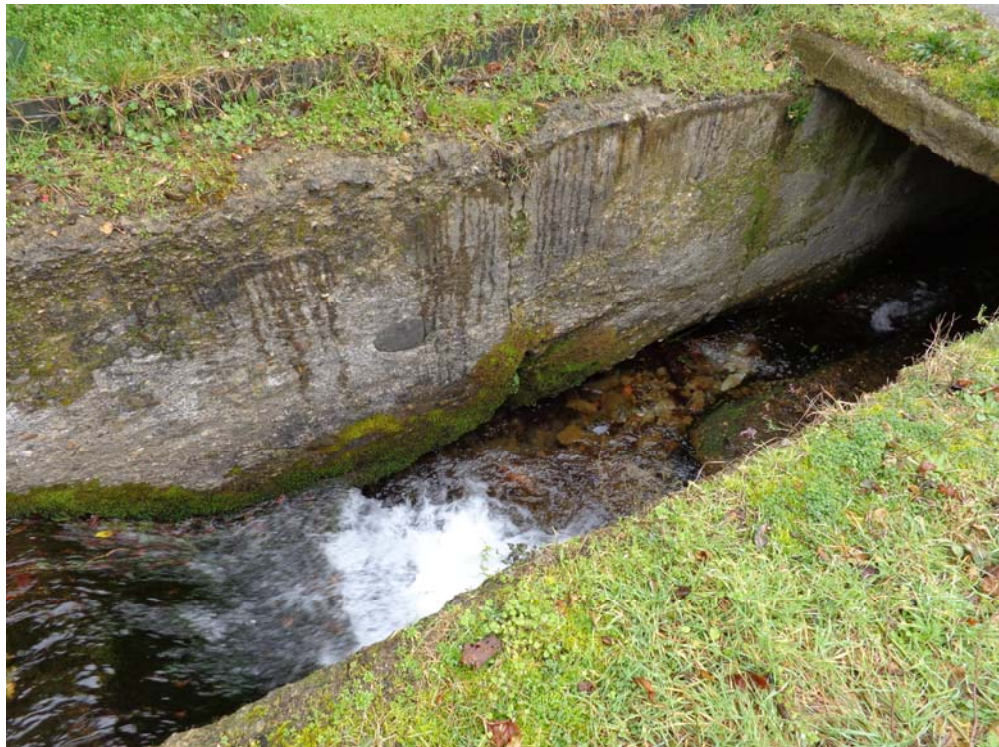
Solera rota en la zona de resalto hidráulico.
