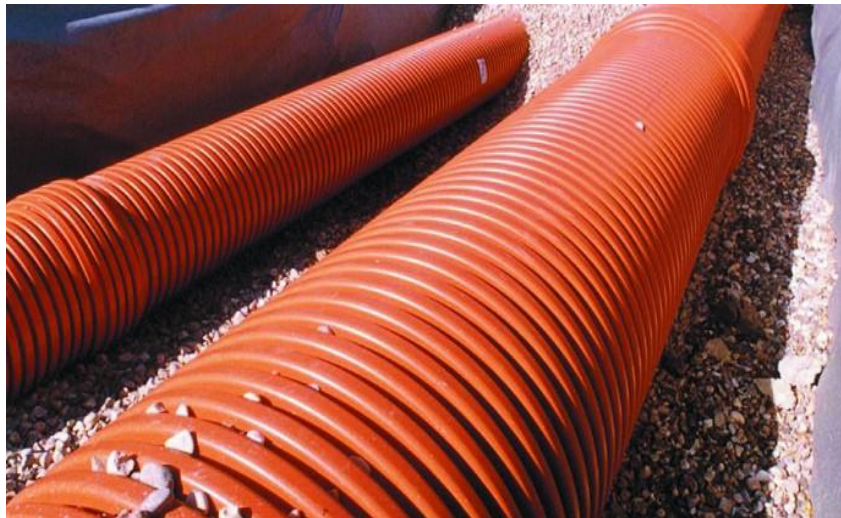
Imagen: Colocación del tubo de PVC corrugado sobre cama de arena de río
