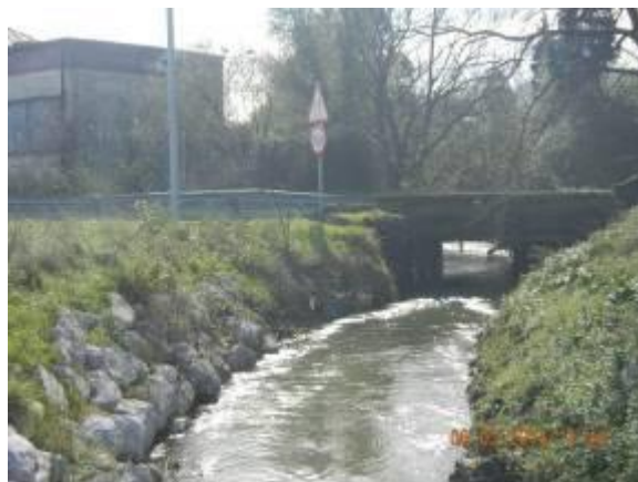
Foto 63 Puente de la c/Bº de Trápaga a sustituir por la obstrucción que causa.
