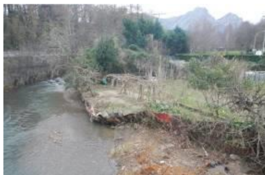
Foto 6. Margen izquierda aguas arriba del puente con evidencias de erosión.
