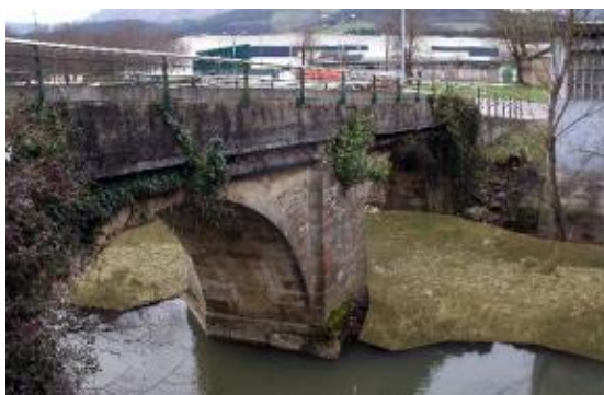
Foto 5. Puente de Astola, ojo de la margen izquierda colmatado.
