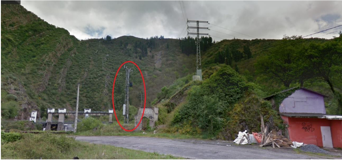
Imagen 8. Poste de conexión y transformador
