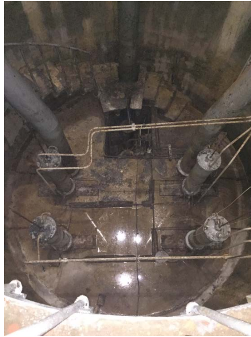
Fotografía 3. Interior de la cámara de válvulas en la torre de mandos.
