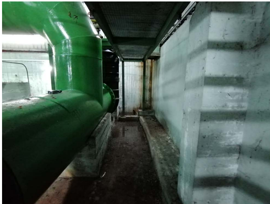
Fotografía 8. Zona donde se realizará el picaje y se instalará el nuevo desagüe con salida al exterior a través de la pared.
