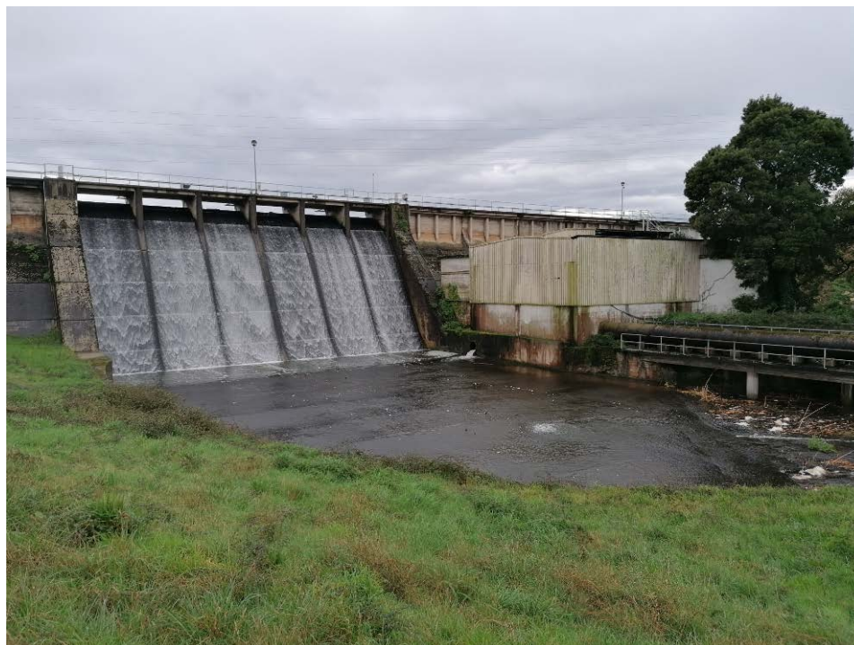
Fotografía 1. Aliviaderos, edificio de cámara de válvulas y salida del desagüe de fondo al río
