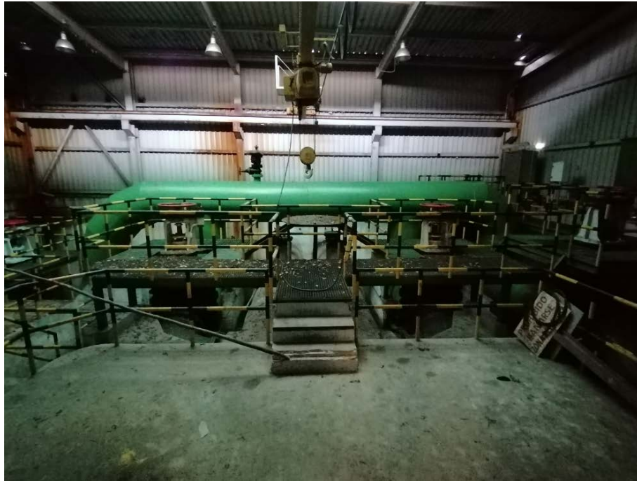
Fotografía 5. Cámara de válvulas sala 2 con tubería a elevada que conecta tomas de aguas altas y bajas con la otra toma de aguas hacia la factoría, la cual es prolongación del desagüe de fondo.
