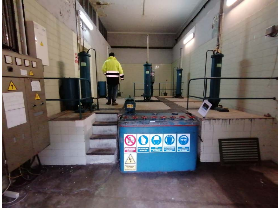
Fotografía 3. Cámara de válvulas sala 1. Válvulas de compuerta generales de salida de las tomas de aguas altas y aguas bajas (DN 900) y conexión entre ambas.
