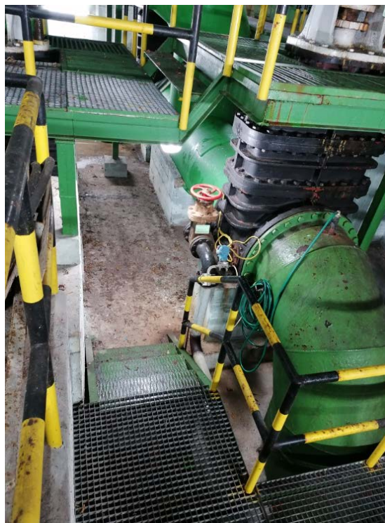
Fotografía 6. Válvula de compuerta 1 en toma de agua a la factoría con salida para caudal ecológico, aguas arriba de conexión con tomas de aguas altas y bajas.
