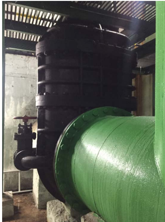
Fotografía 7. Válvula de compuerta 2 en toma de agua a la factoría con bypass integrado, aguas abajo de conexión con tomas de aguas altas y bajas y antes de que la tubería salga del edificio.
