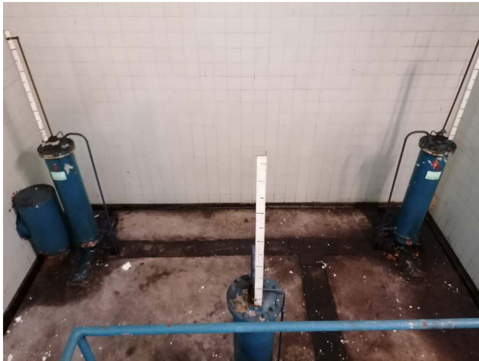
Fotografía 4. Cámara de válvulas sala 1, nivel inferior. Válvulas de compuerta generales de salida del desagüe de fondo (DN 900) y válvula de conexión con toma de agua bajas.
