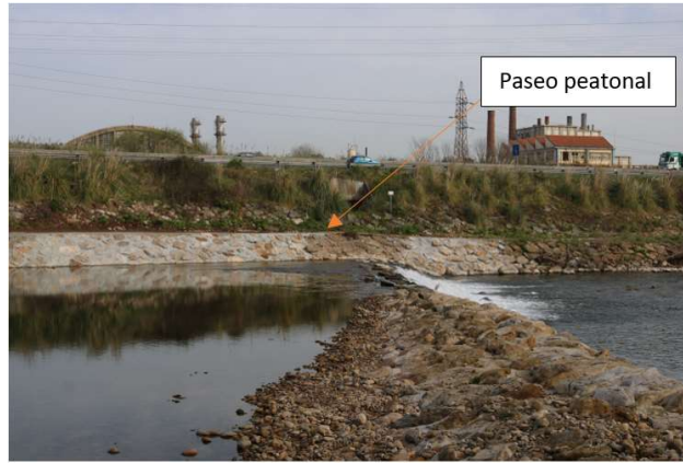
Imagen 6. Azud de la Lechera. Estado actual.
