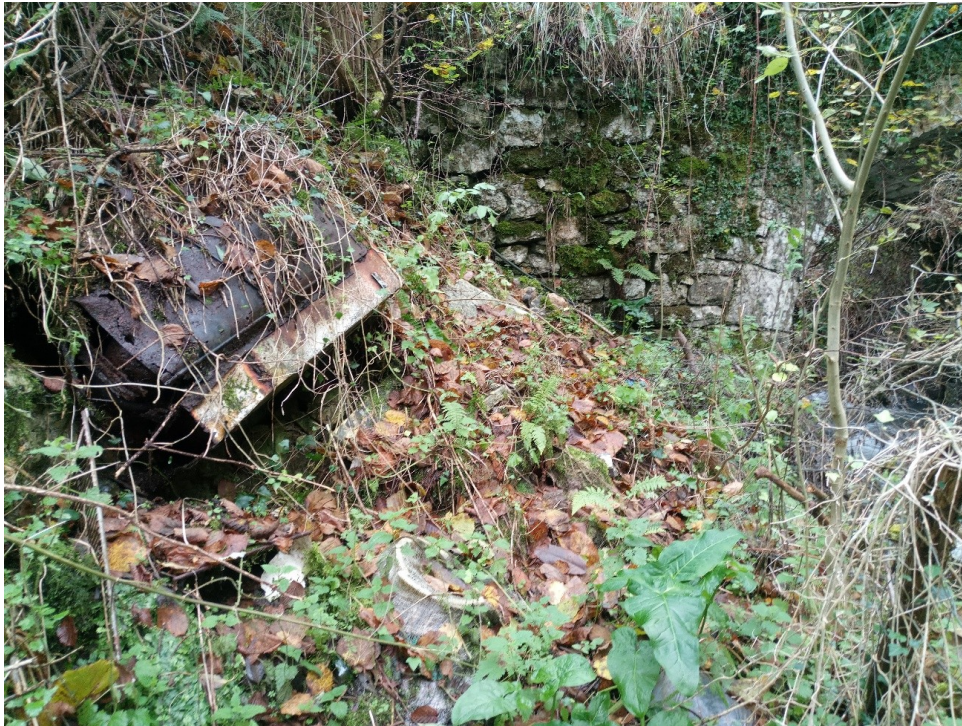
Varios residuos en las inmediaciones del puente.
