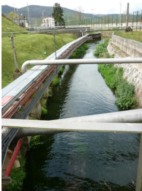
Derivación de agua para uso industrial
