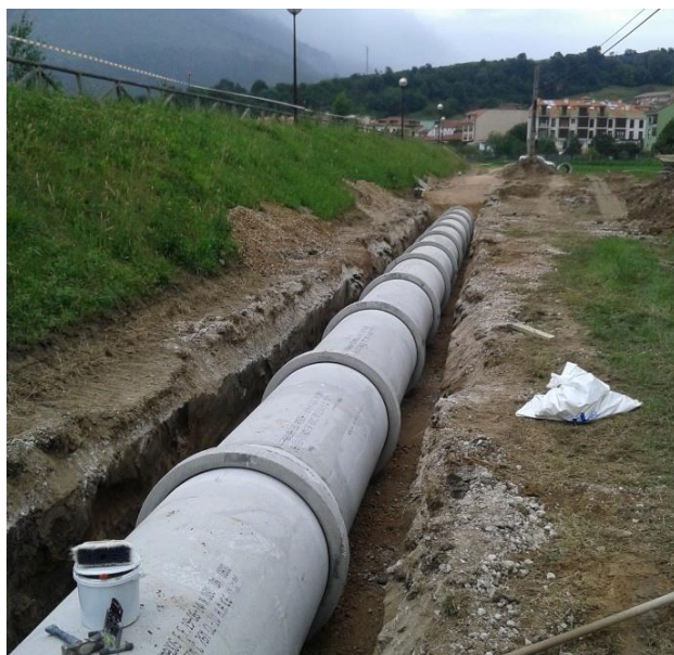
Colector de saneamiento Panes - río Deva
