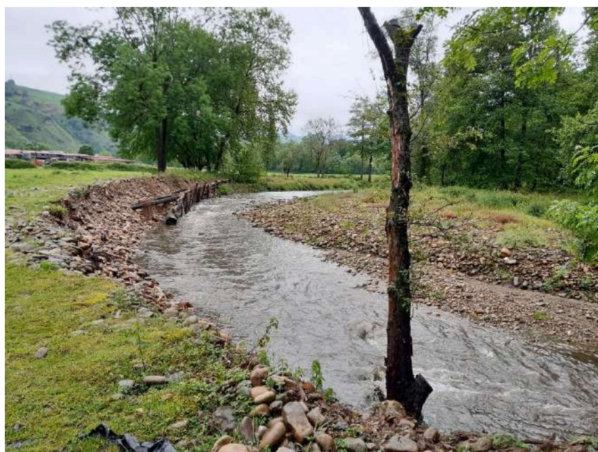
Previo a la actuación: erosión en el trasdós de la bioingeniería y acumulación de acarreo del punto 3
