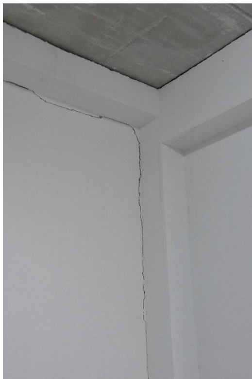
Imagen 15.- Vista de la fisura anterior.
