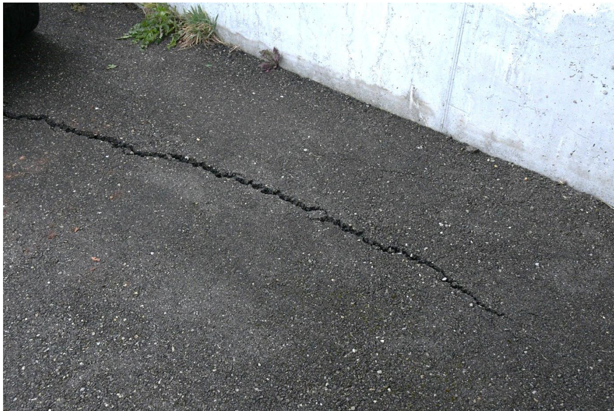
Imagen 26.- Detalle de fisura en el firme en las inmediaciones de la cámara de llaves.
