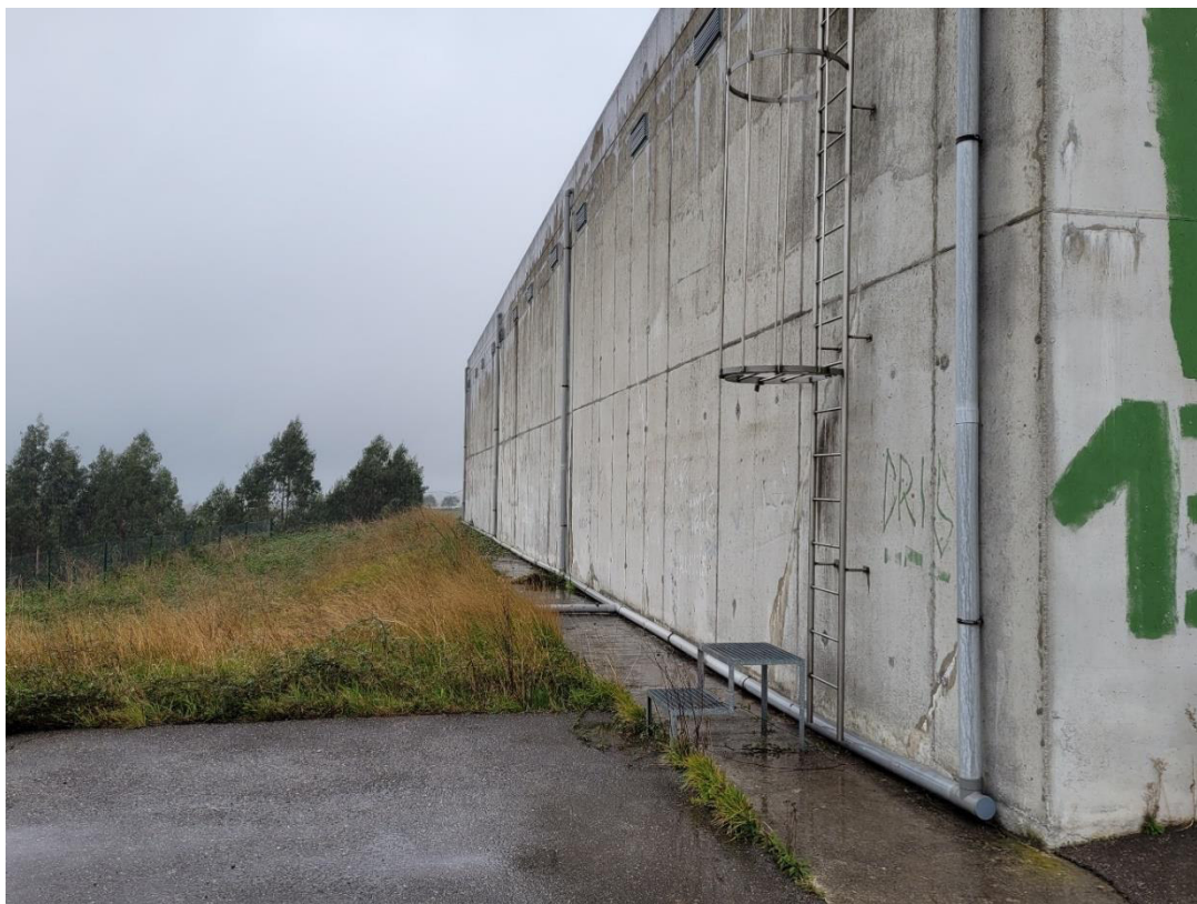
Imagen 4.- Vista exterior del muro oeste con fisuras en la zona del encuentro con el muro sur.
