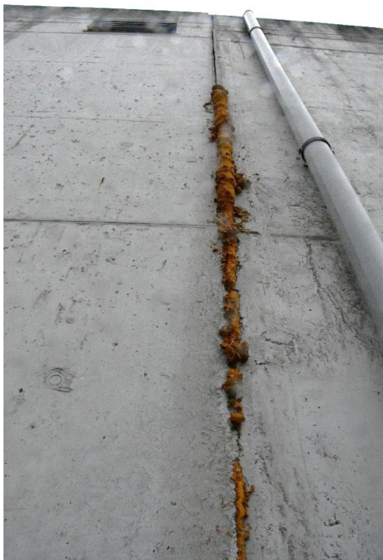
Imagen 7.- Junta de construcción en el muro este, con material hidroexpansivo visible por la presencia de agua.
