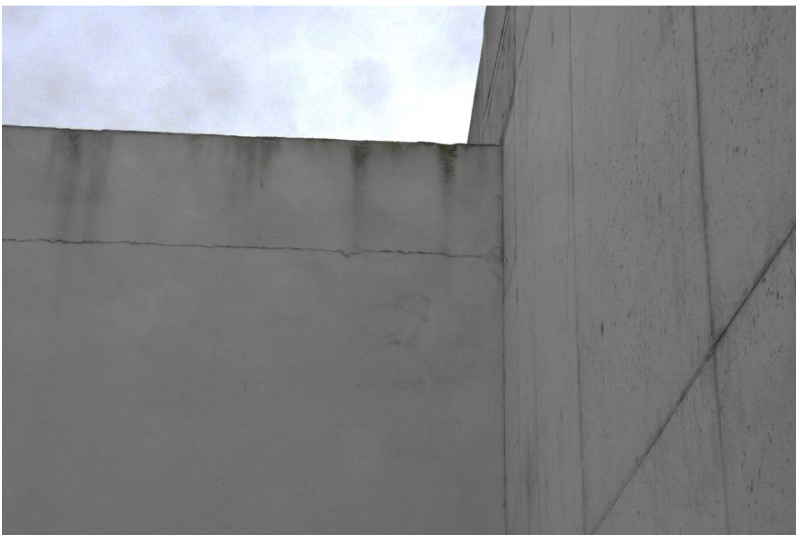
Imagen 9.- Fisura en unión de muro este con elemento de remate de cubierta de la cámara de llaves.
