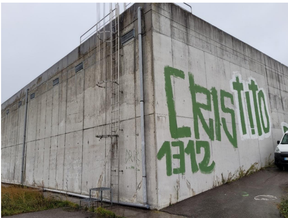
Imagen 3.- Vista exterior suroeste con fisuras en la parte inferior de los muros.
