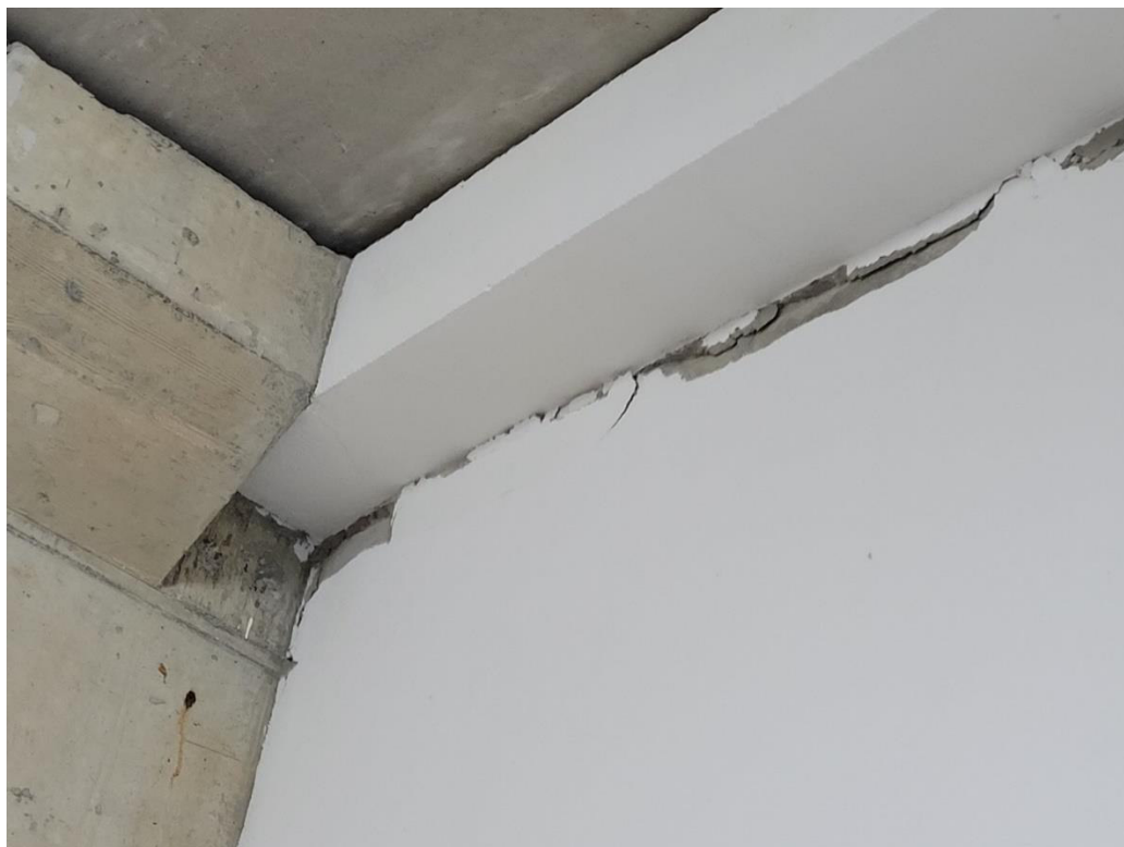
Imagen 13.- Interior de la cámara de llaves con grieta en coronación de muro a lo largo de la viga.
