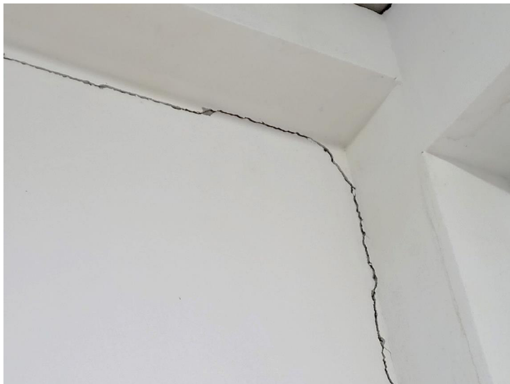
Imagen 14.- Interior de la cámara de llaves con grieta en coronación de muro, a lo largo de la viga de cubierta, y vertical, a lo largo del pilar.
