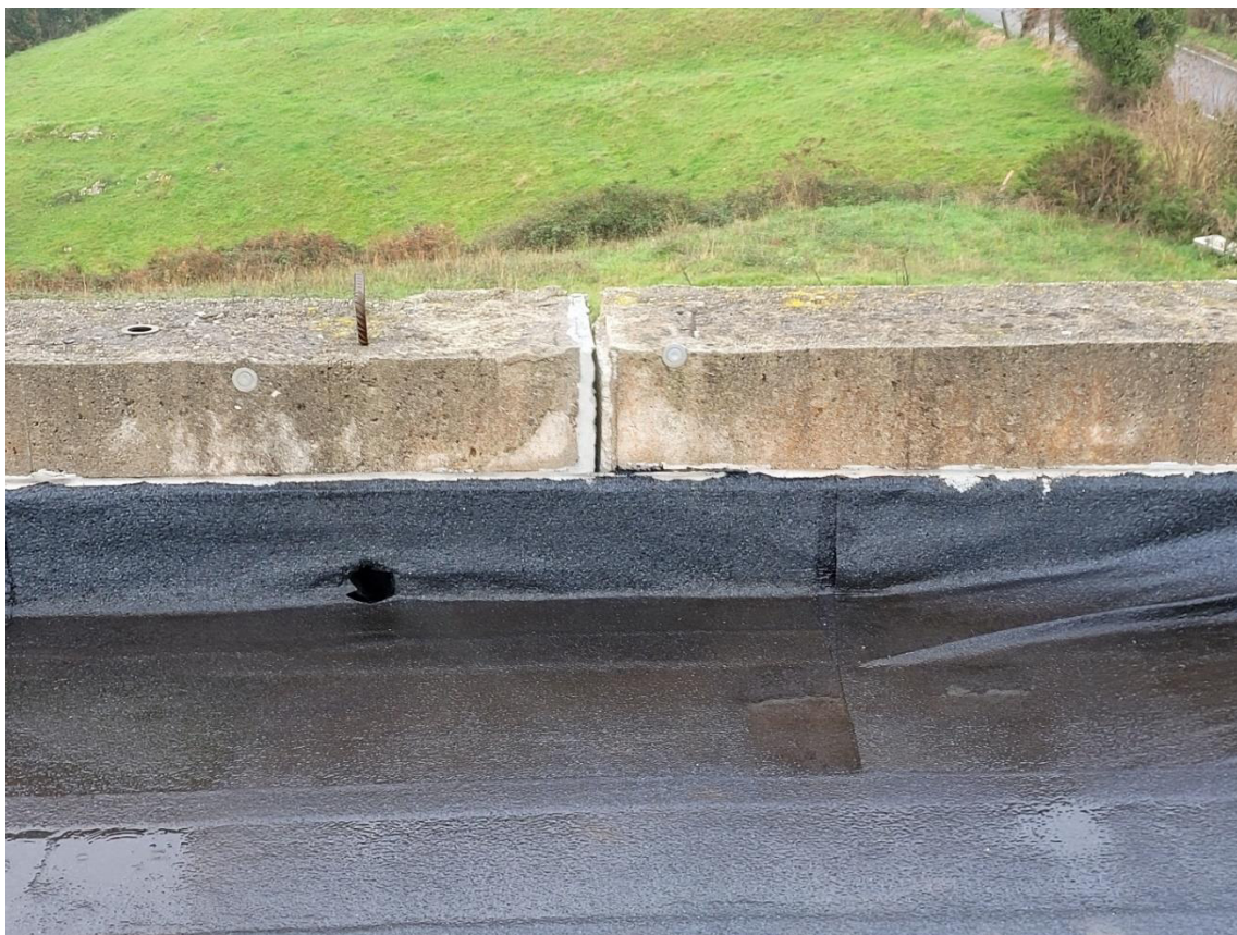
Imagen 19.- Desplazamiento relativo en junta de coronación de muro.
