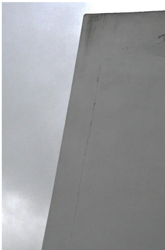
Imagen 8.- Grieta vertical en la esquina entre los muros este y sur.
