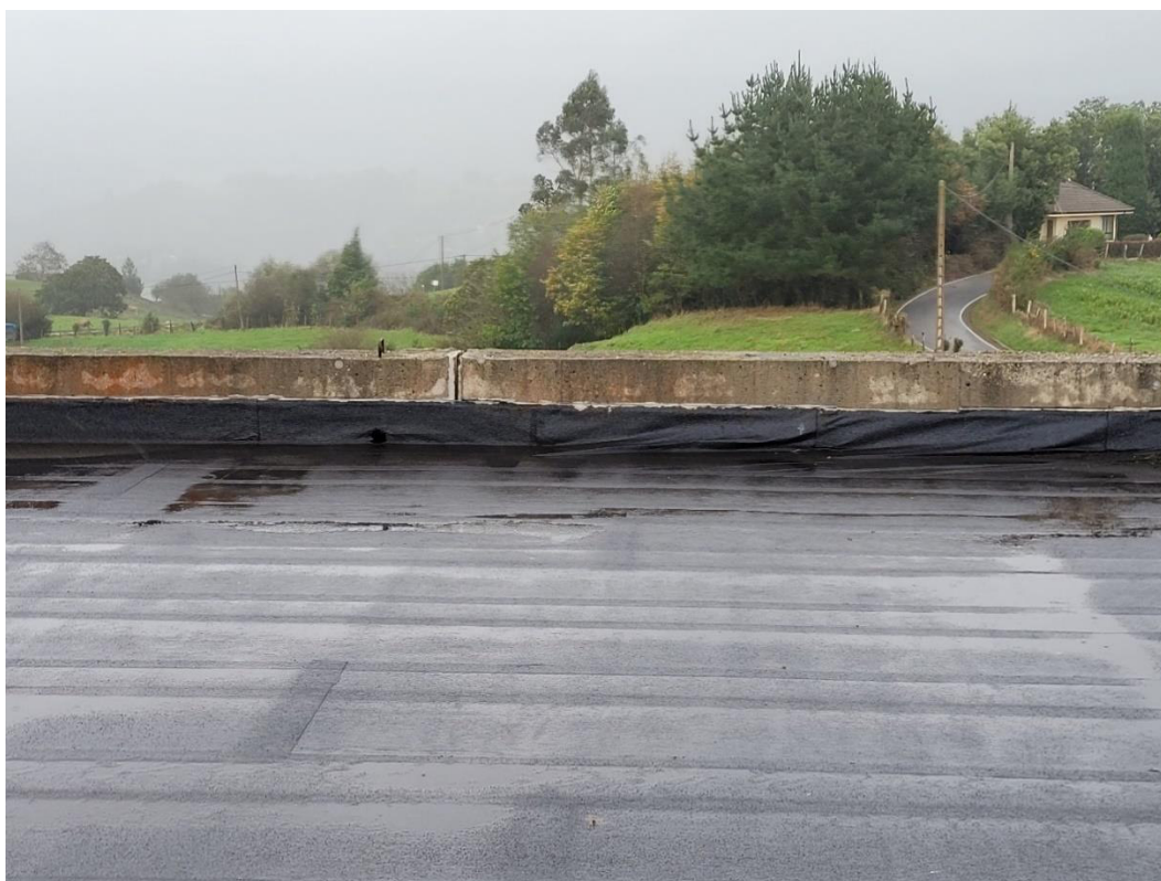
Imagen 18.- Apertura de junta en la coronación del muro este.
