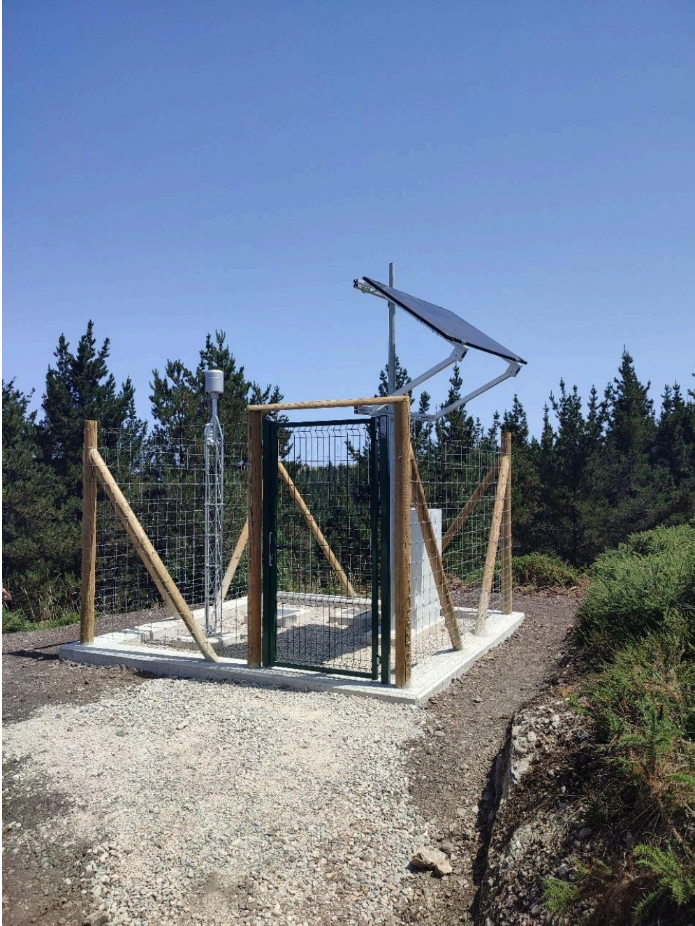
Nueva estación en el cerro Gavio (Asturias)
