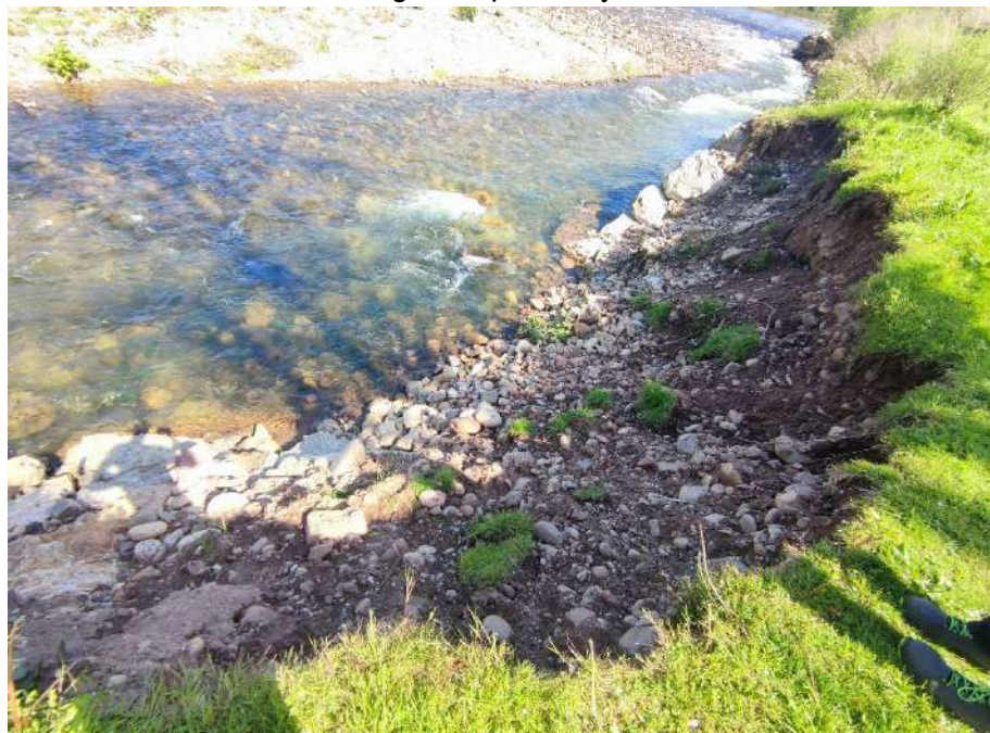
Derrumbe formado en la margen izquierda
