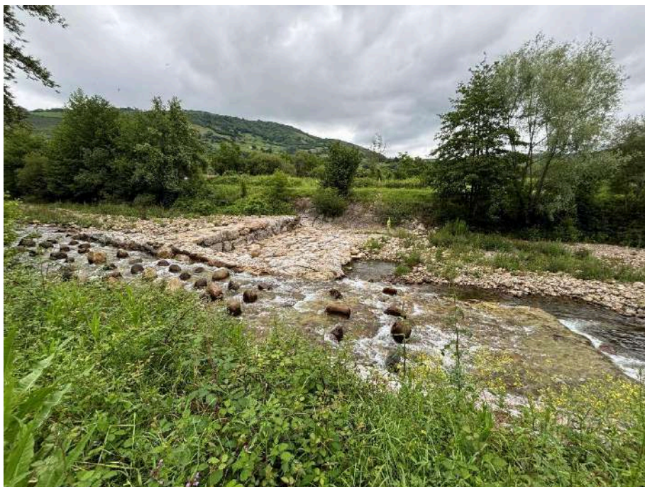
Dispositivo de paso piscícola afectado por el descalce (paso piscícola de aguas arriba)
