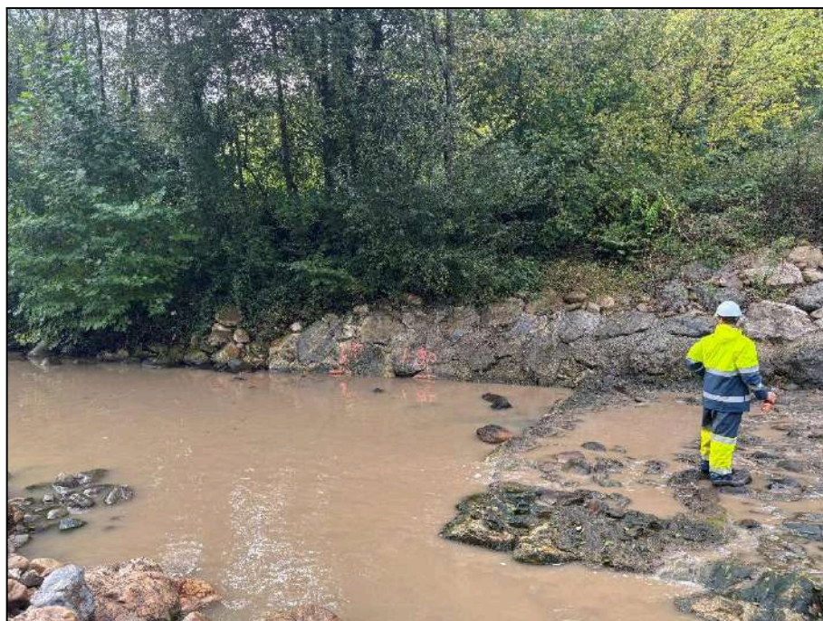
Rampa de piedras afectada por el descalce una vez desviado el cauce
