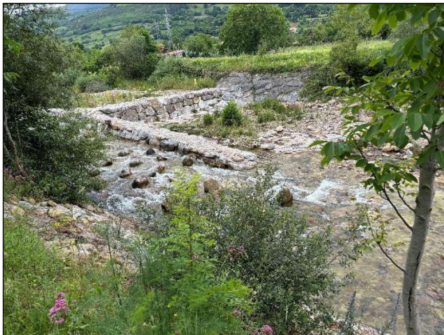
Dispositivo de paso piscícola afectado por el descalce (paso piscícola de aguas abajo)
