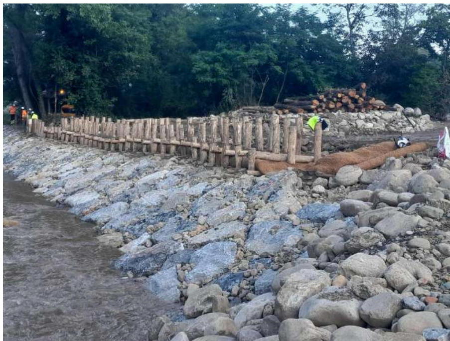
Trabajos de bioingeniería, aguas arriba del azud, para recuperar el cauce original del río Besaya
