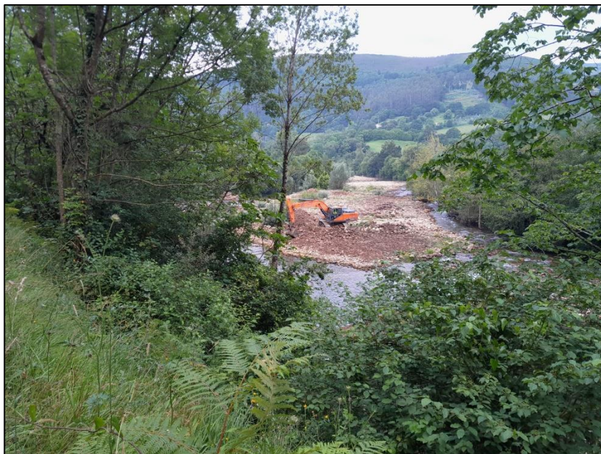
Vista general de los trabajos en la isla central del río Pas
