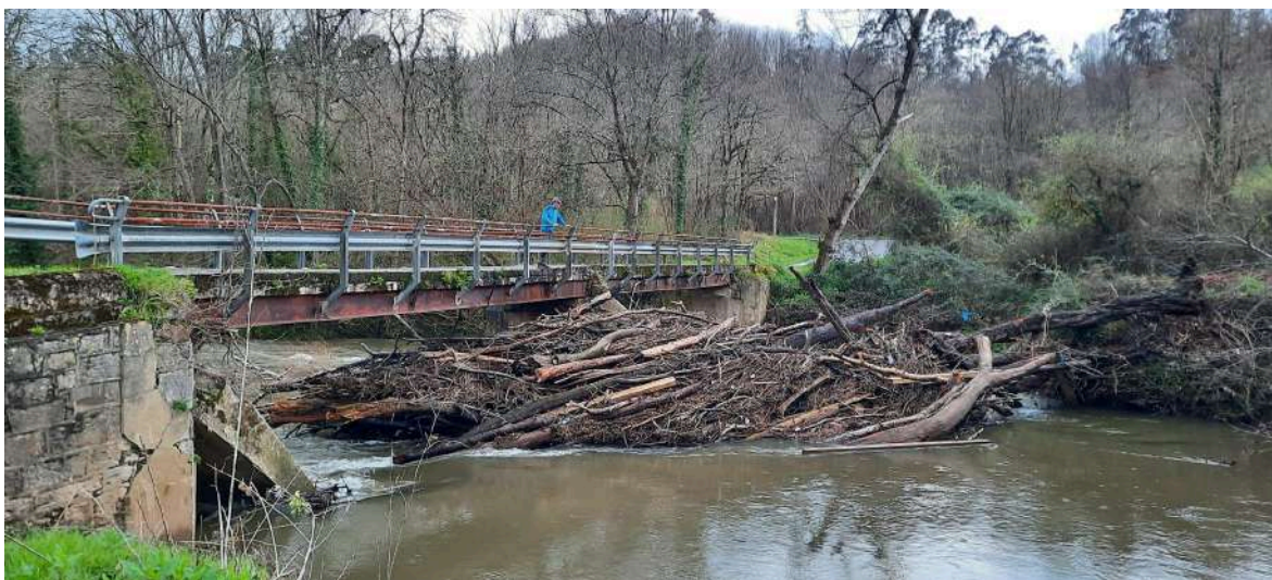
Antes de los trabajos. Tapón vegetal en el puente del Regidorio
