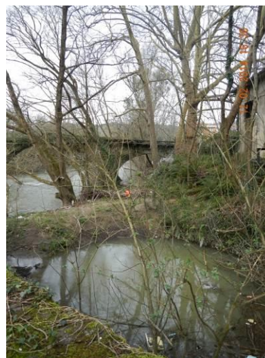
Figura 197.- Obstrucción ojo derecho puente de Torrezabal
