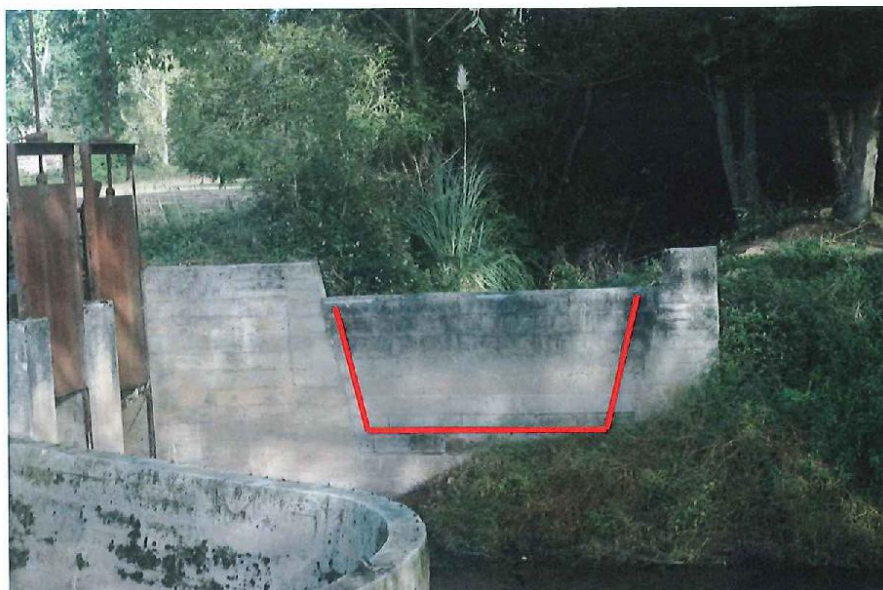
Toma de alimentación inhabilitada por paramento de bloque
