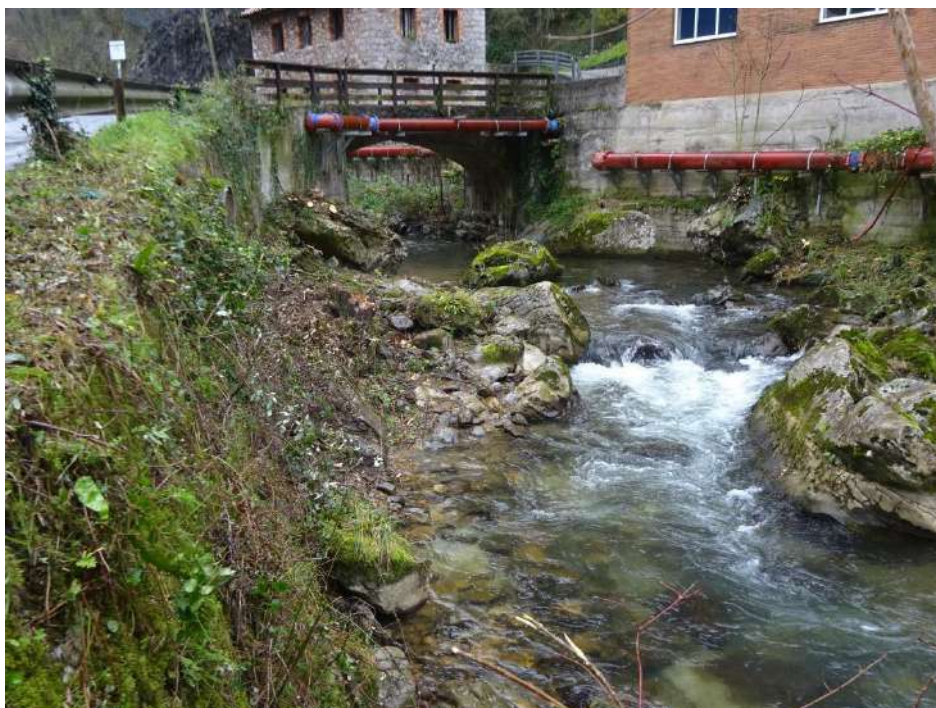
Zona de actuación después de la retirada de los restos vegetales acumulados
