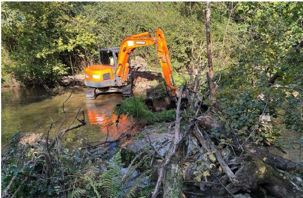
Restos vegetales acumulados sobre el azud
