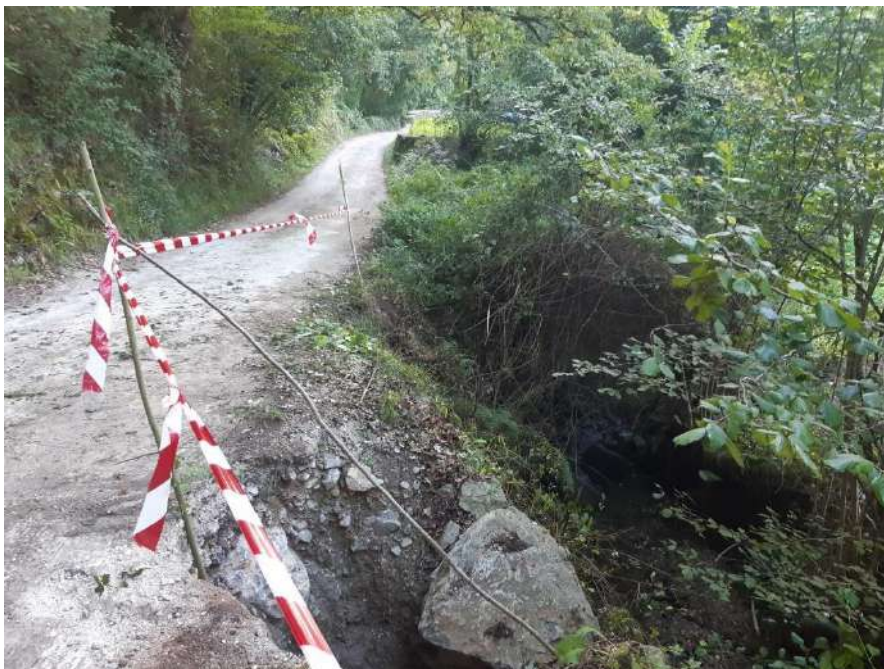
Escollera afectada por la erosión
