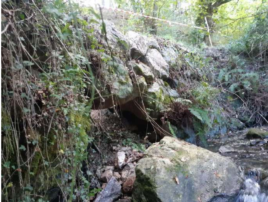
Desprendimientos en la escollera de la margen derecha
