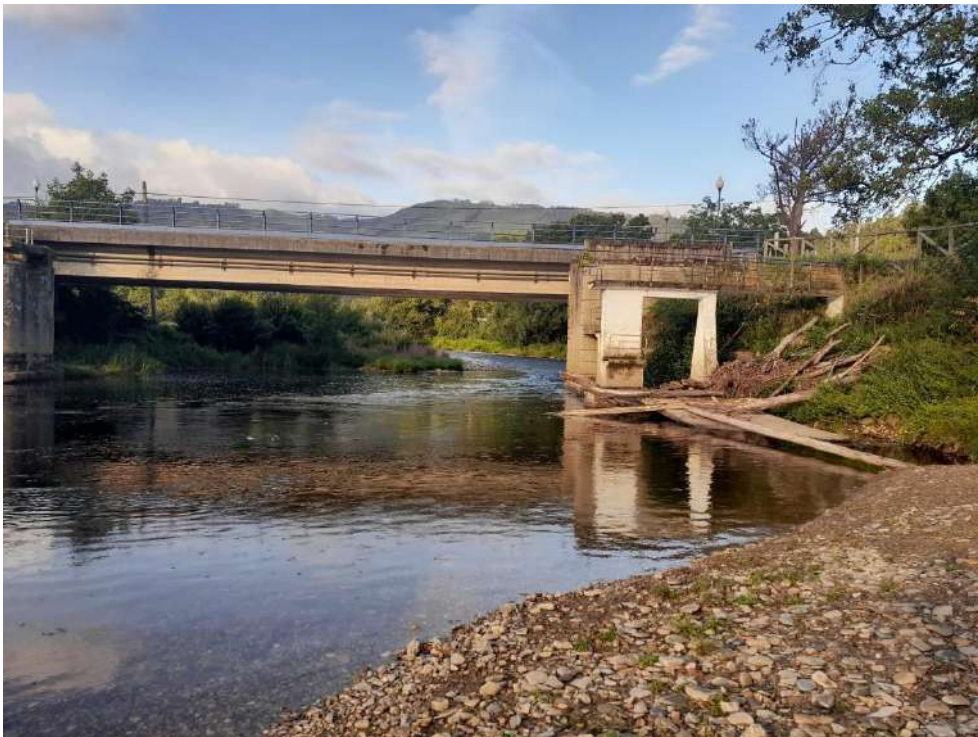
Restos vegetales acumulados en un puente de paso sobre el río Eo
