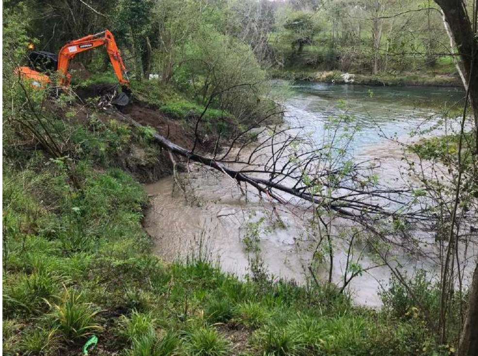
Labores de extracción de árboles caídos
