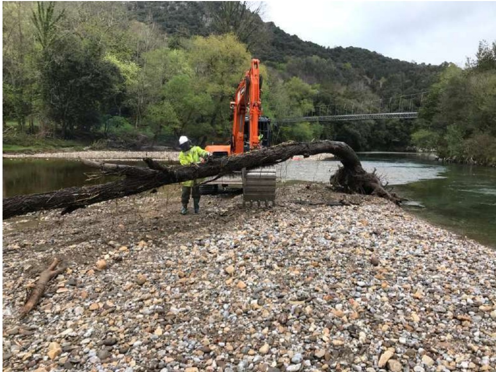
Labores de extracción de árboles caídos
