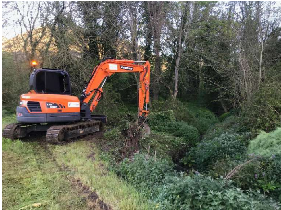
Retirada de tapón formado por restos vegetales
