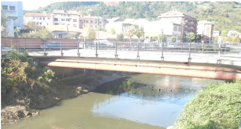
Figura 77.- Puente de Zubialde Kalea a eliminar.
