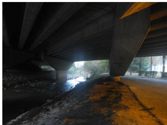
Figura 95.- Punto de cierre de la mota con el estribo de la A-8 y zona para la disposición de muro. Se recomienda cerrar hasta tablero
