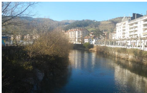
Figura 185.- Muros con presencia de avión zapador aguas arriba de la plaza de toros
