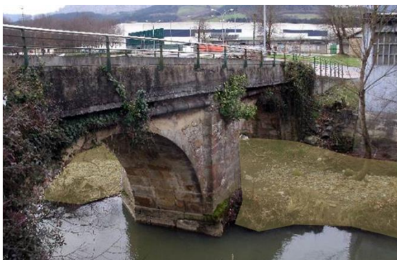
Figura 151.- Puente de Astola, ojo de la margen izquierda colmatado
