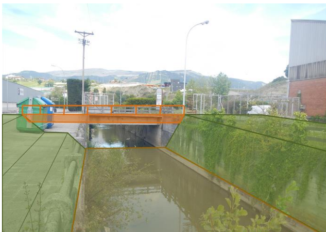
Figura 150.- Paso a sustituir en zona industrial
