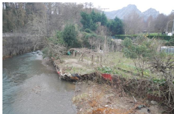
Figura 152.- Margen izquierda aguas arriba del puente con evidencias de erosión
