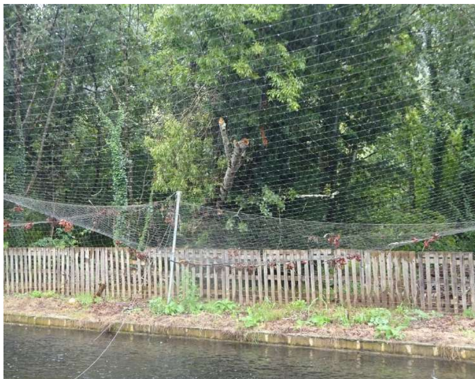
Instalaciones de la piscifactoría afectadas por el árbol caído
