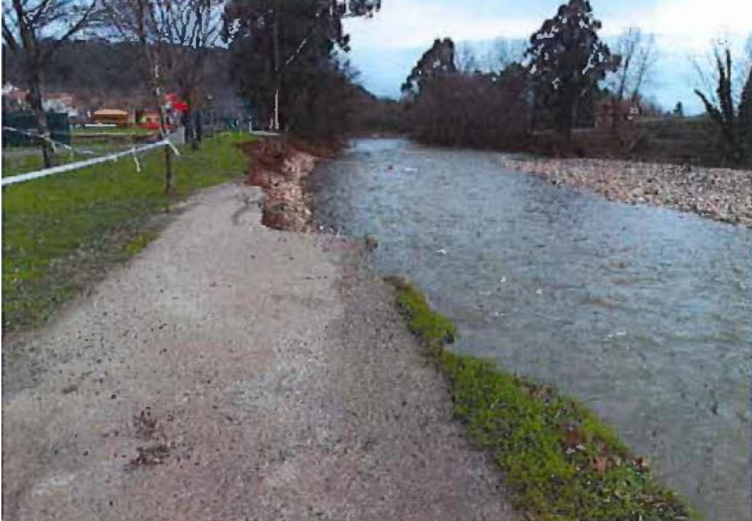
Vista de los efectos sobre el carril bici y margen izquierda desde ubicación aguas arriba
