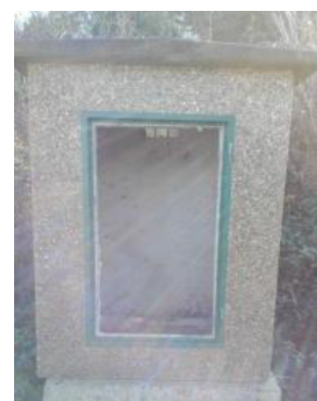
Pozo sin puerta
