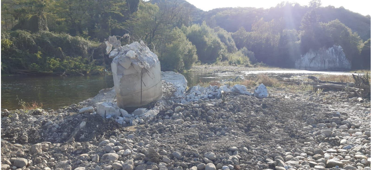
Antes de la retirada de la zapata en el río Nalón en Palomar
