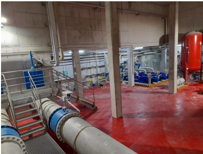
Bombeo de fangos Gijón Este
