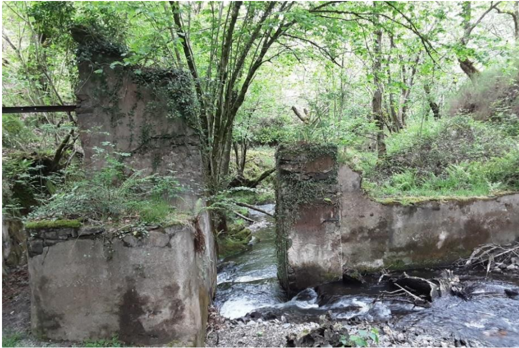
Demolición del azud en la regata Itzazola en Goizueta (antes de la actuación)
