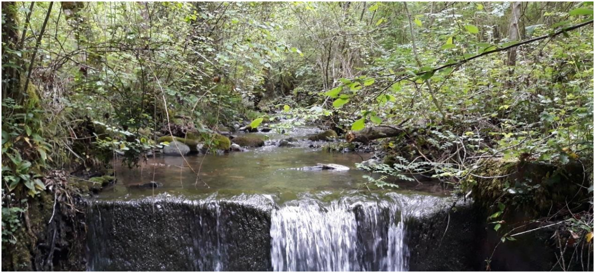
Demolición del azud en la regata Urandi en Ziga, Baztan (antes de la actuación)
