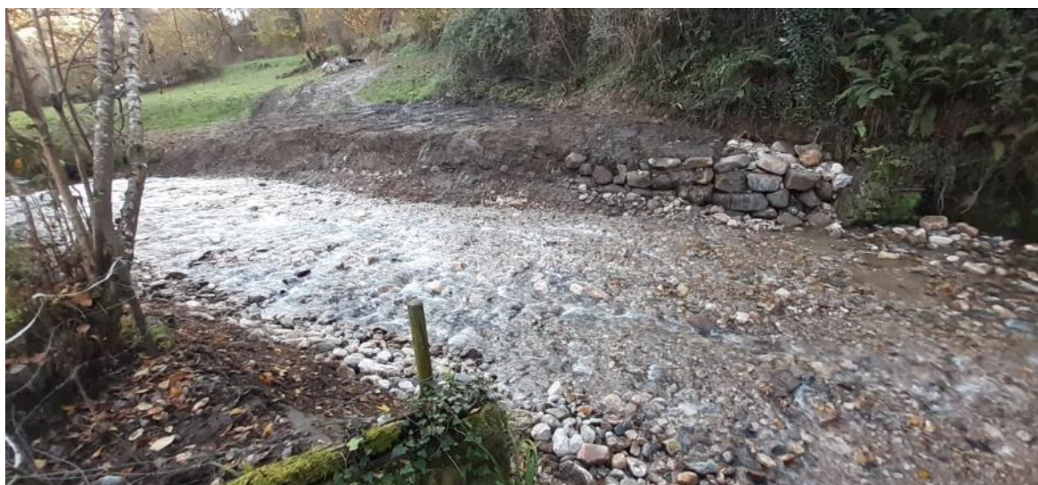
Después de la retirada del azud del río Tendi en Caldevilla (2)
