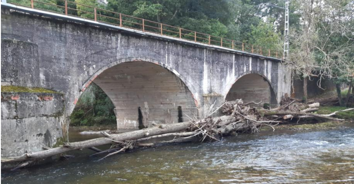
Puente con restos vegetales acumulados antes de la actuación
