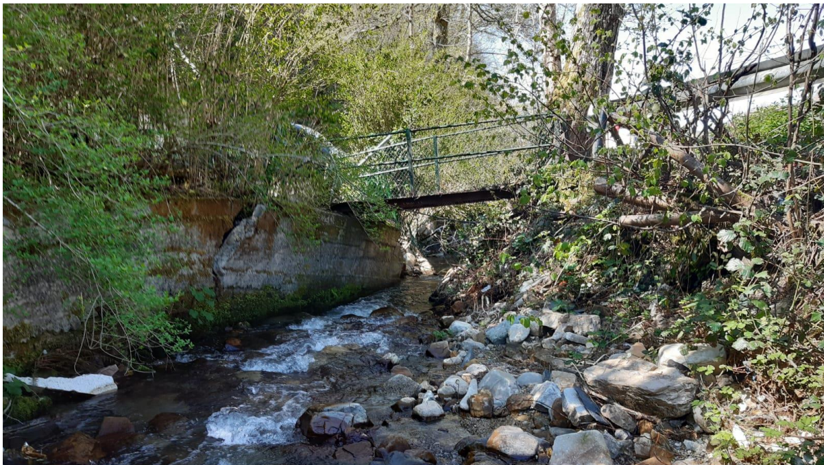
Muro colapsado sobre el cauce del río la Collada
