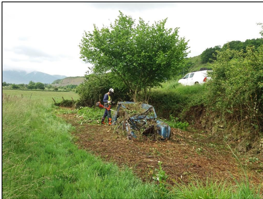
Desbroce y retirada de los residuos que aparecen en la margen (chasis coche)
