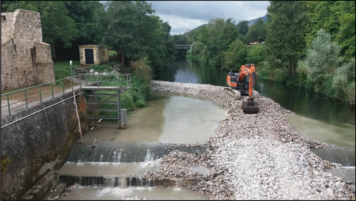
Construcción de cordón para desecar y proteger la zona donde se va a construir la escala
